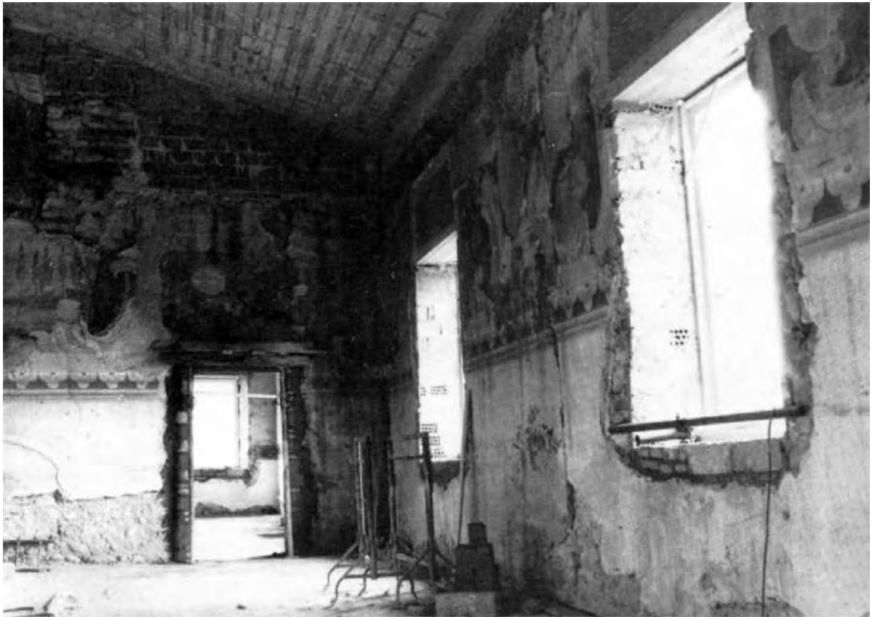
Due immagini dei danni provocati dall'incendio dell'oratorio.
